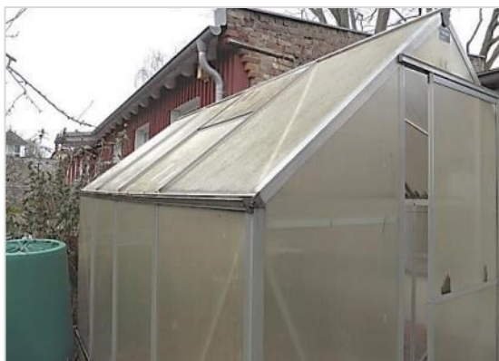
Gewächshaus mit Grünalgenbelag außen
